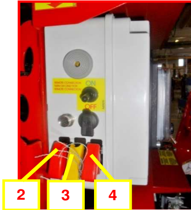
Figure 5 : côté gauche du boîtier électrique.
