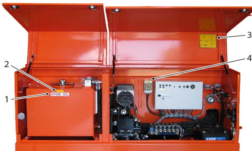
Compartiment d'huile hydraulique et compartiment des soupapes/électricité
