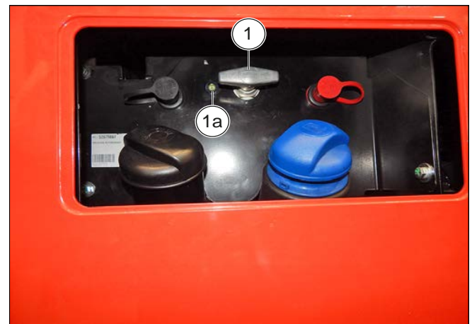
Afbeelding 66: Schakelaar voor ont koppeling van de accu
